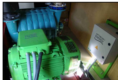
Exemple d'économie d'énergie sur le process : moteurs intégrant un bobinage optimum équipant des soufflantes - Villiers Saint Frédéric (78) - 20 000 EH
